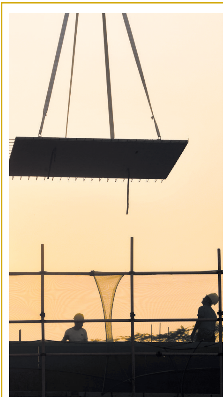
君临华苑安居房项目现场,施工人员正吊装装配板。 本报记者 苏弼坤 摄
