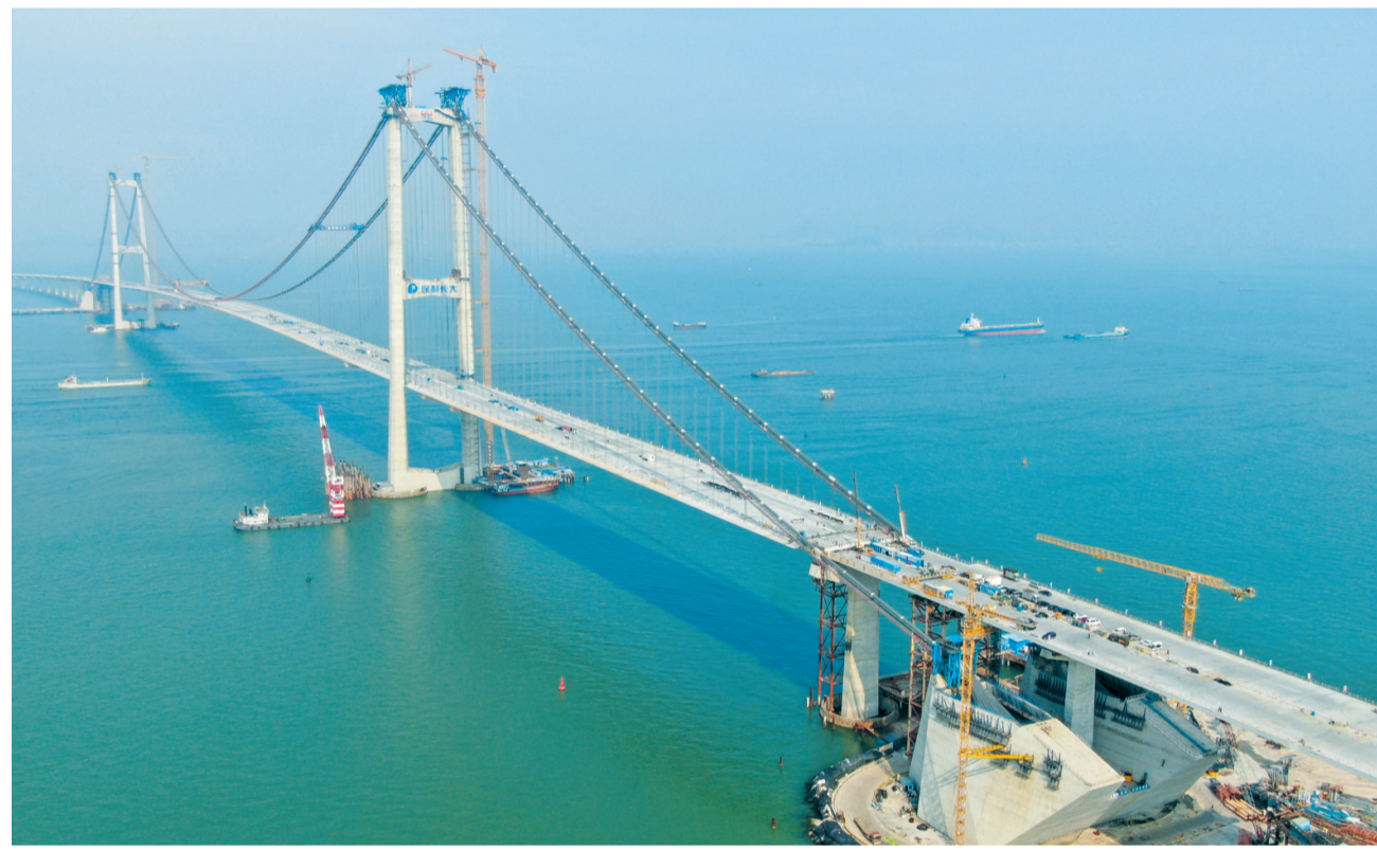
这是4月27日拍摄的深中通道伶仃洋大桥及西锚碇(无人机照片)。 新华社记者 邓华 摄
