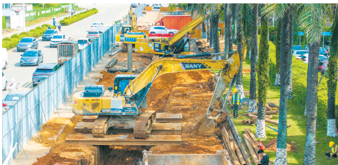
海口综保区金盘园区基础设施提质升级改造项目施工现场有序进行。
