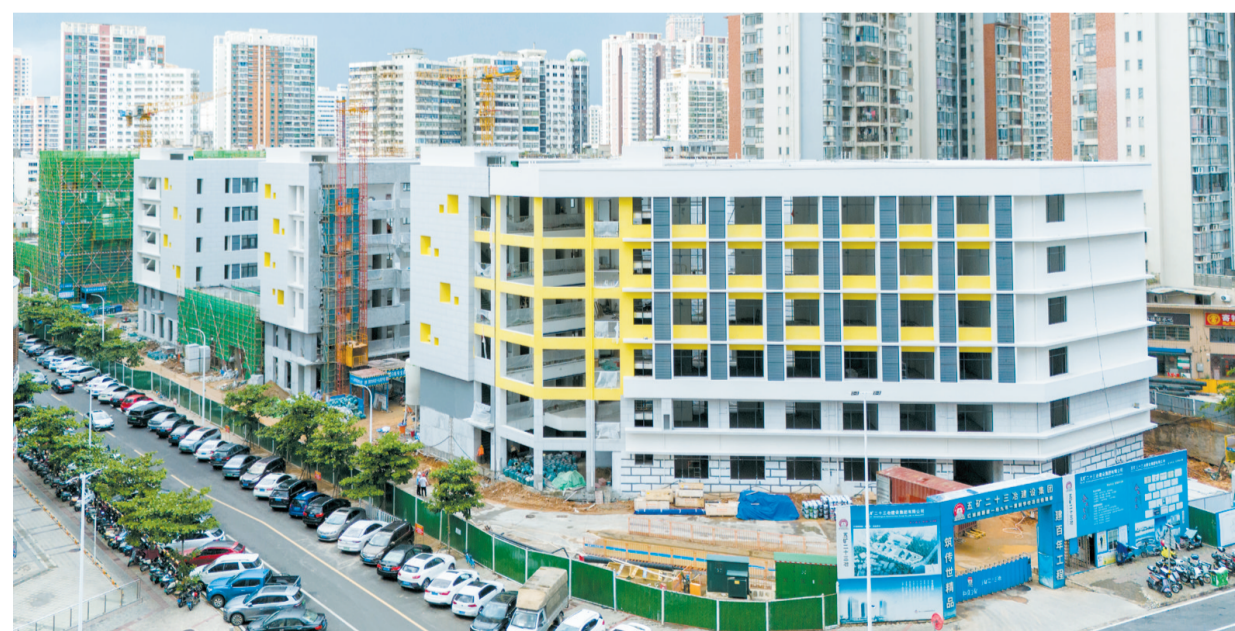
7月19日,航拍位于琼山区龙昆南路东侧、海德路南侧的红城湖九年一贯制学校(新建)项目现场。
