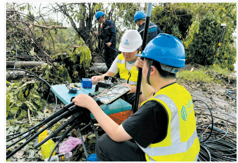
9月10日,通信维护人员在西秀镇新和村通信基站附近开展抢修工作。
