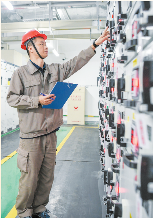
4月7日,在海南国际会展中心,工作人员正在查看配电房设施,保障场馆电力供应。
