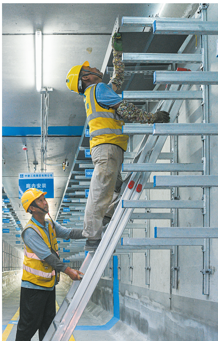
近日，在海口江东大道二期西段综合管廊项目示范段内，施工人员在安装桥架。 本报记者 苏弼坤 摄
