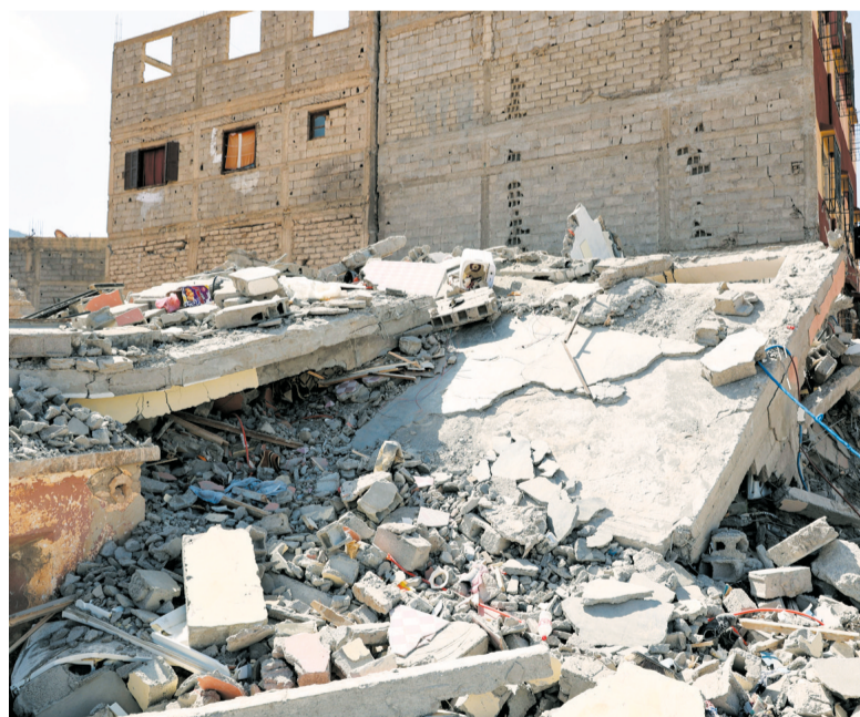
这是9月10日在摩洛哥震中附近的艾兹鲁村拍摄的损毁建筑。 新华社记者 霍晶 摄
