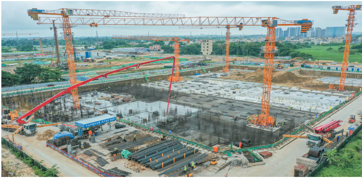
▲5月31日,江东新区春晖园A06回迁房项目现场塔吊林立,施工车辆来回穿梭,一派热火朝天的施工景象。本报记者 孙士杰 摄
