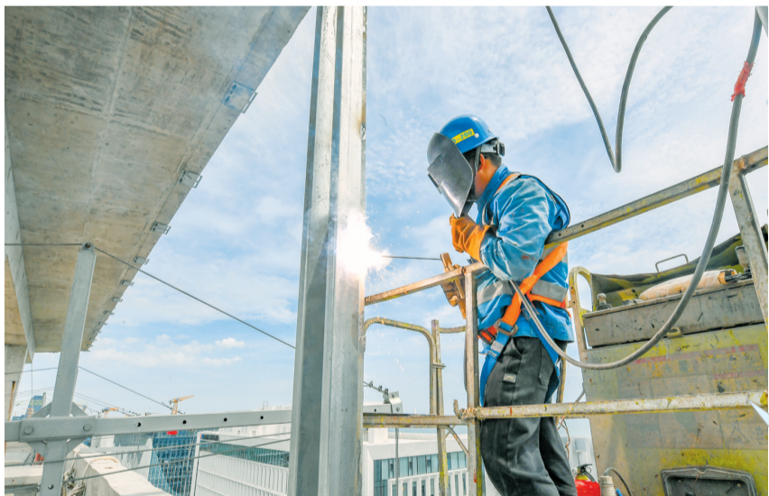
◀6月4日,在南方电网新型电力系统研发中心,施工人员在焊接龙骨。本报记者 孙士杰 摄
