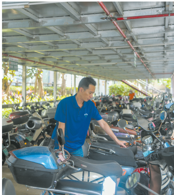
可以供小区业主充电。佳元·椰风水韵小区刚建成投用的电动自行车棚。
