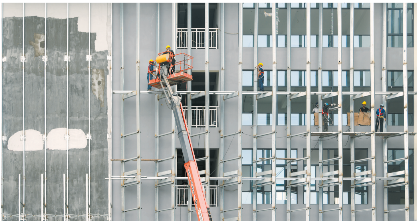
6月5日,在海南大学观澜湖校区教学及生活服务设施(二期)项目现场,施工人员正加快国际影视及设计学院楼的收尾施工。 本报记者 杨鹤 摄
