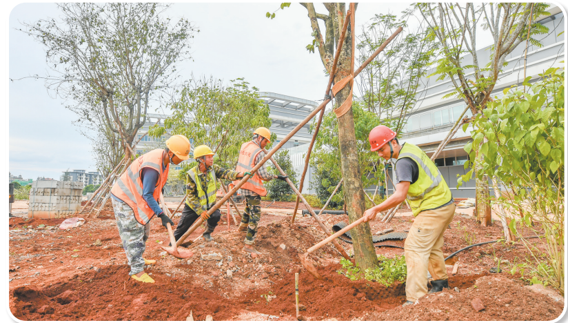
在龙华区海南省人民医院南院(观澜湖)项目工地,施工人员在栽种树木。 本报记者 孙士杰 摄
