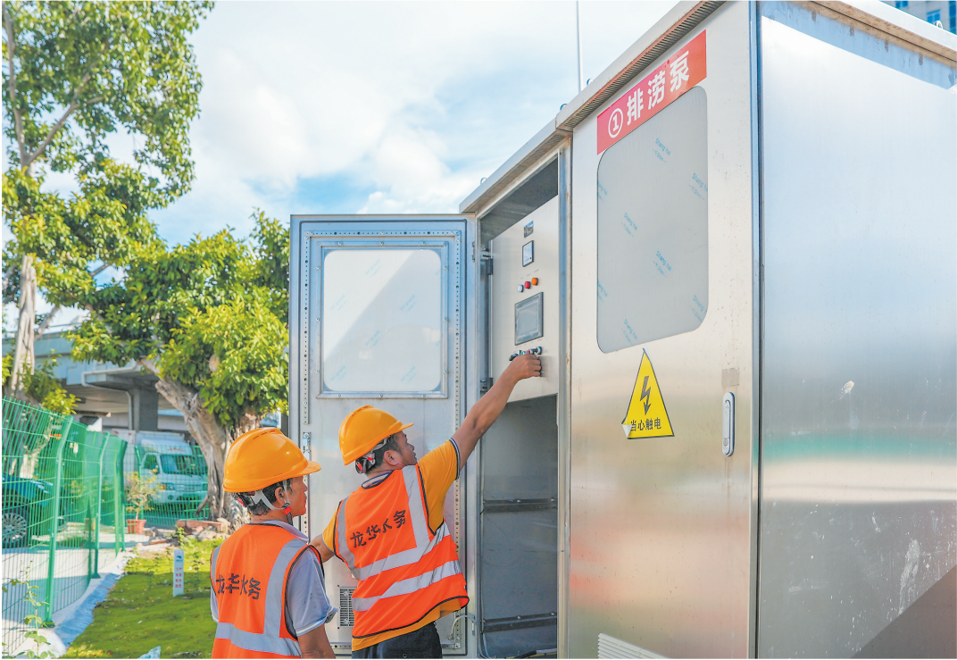
7月28日,在义龙西雨水排涝泵站,工作人员正在进行日常巡检。
