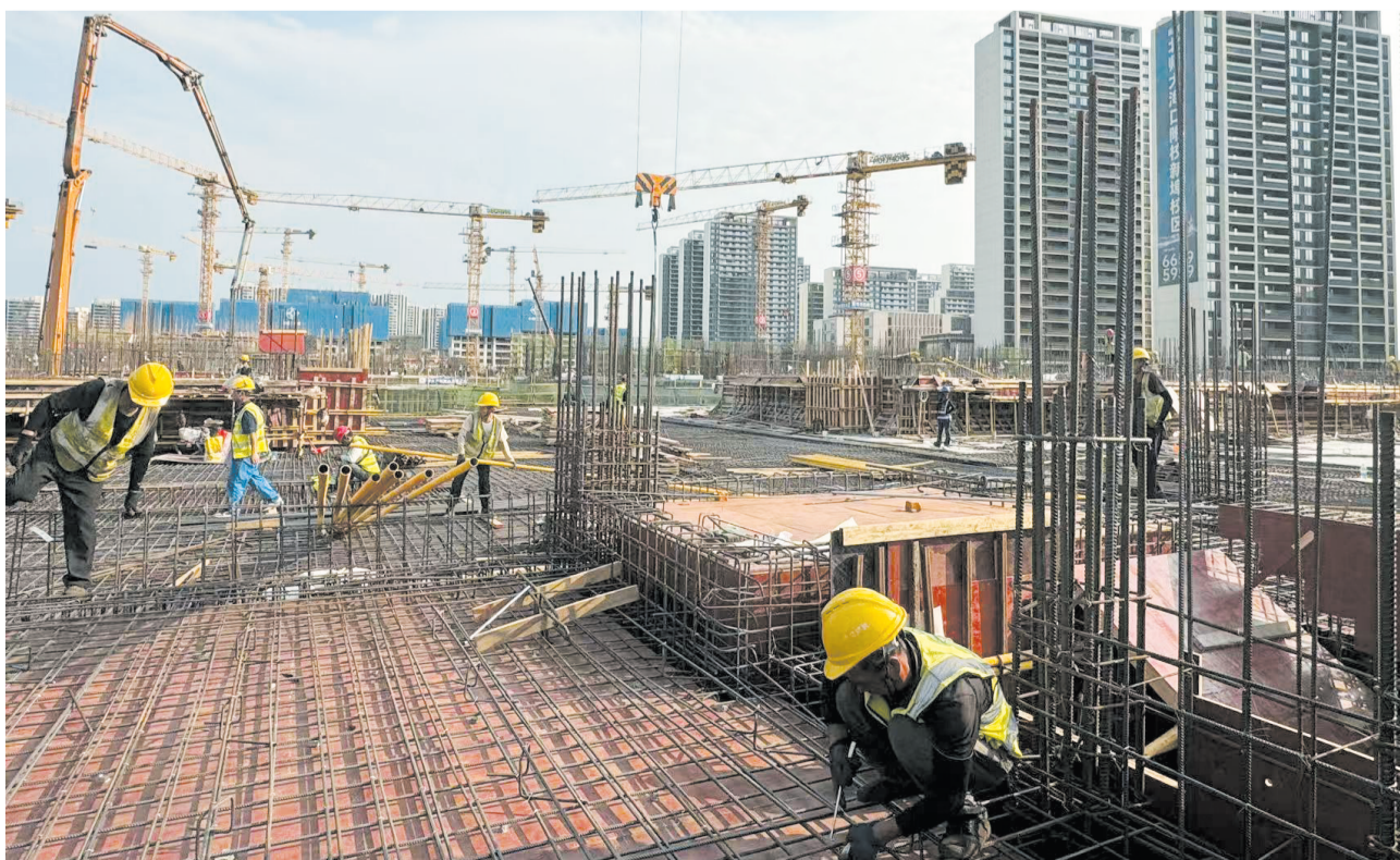
3月30日，在海口市横沟村城市更新项目二期施工现场，工人们正忙着开展钢筋绑扎、混凝土浇筑等工序。
