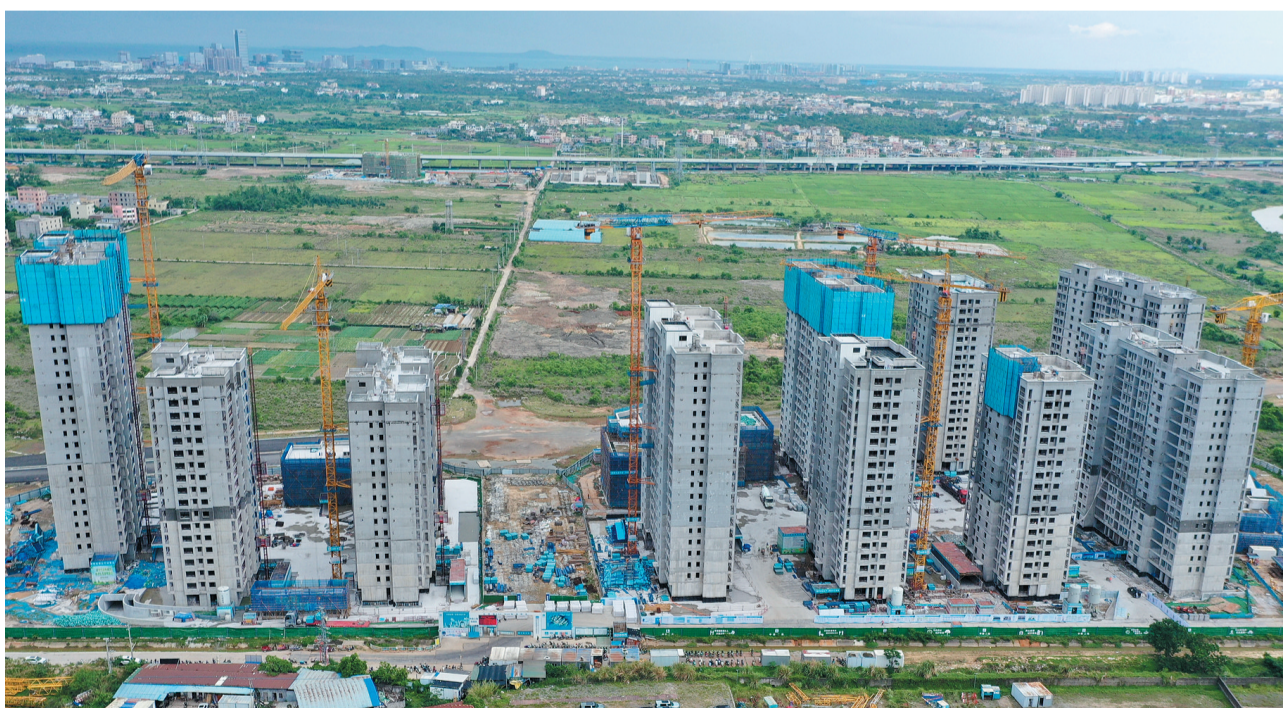
5月6日，俯瞰江东新区兰香园D04、D06地块回迁房项目现场，一派热火朝天的施工景象。 本报记者 杨忠凯 摄
