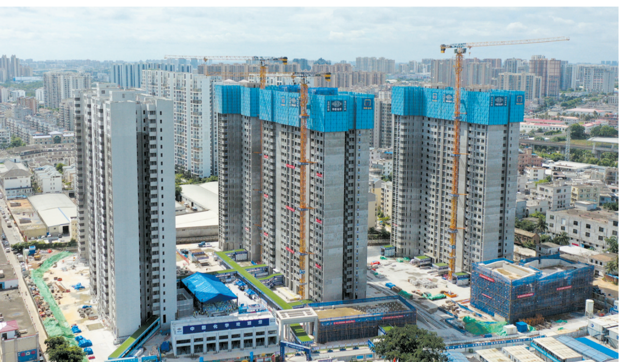
正在建设中的海口金城·金邦安居房项目。 本报记者 高潮 摄
