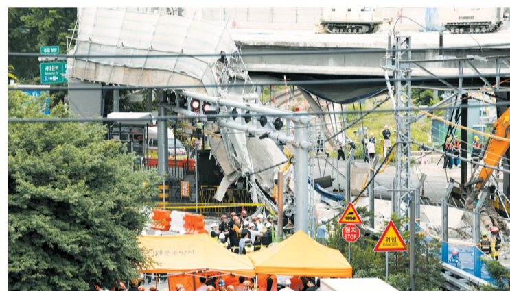
这是5月26日在韩国首尔拍摄的高架桥坍塌事故现场。韩国首都首尔一座高架桥的拆除现场5日下午发生坍塌事故,目前已造成3人死亡,至少6人受伤。新华社发
