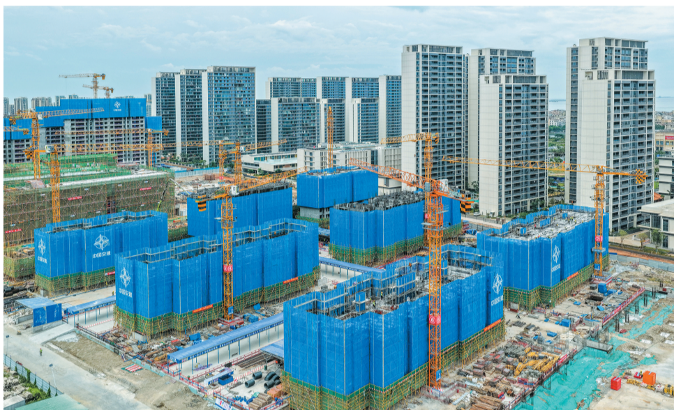
海口市横沟村城市更新项目(二期)C17-01地块、C28-01地块及配套施工工程项目现场,一派繁忙的建设景象。 本报记者 康登淋 摄
