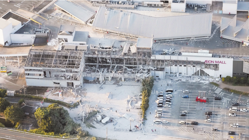
这是7月28日在日本熊本县嘉岛町拍摄的处受损的大型商业设施。新华社共同社
