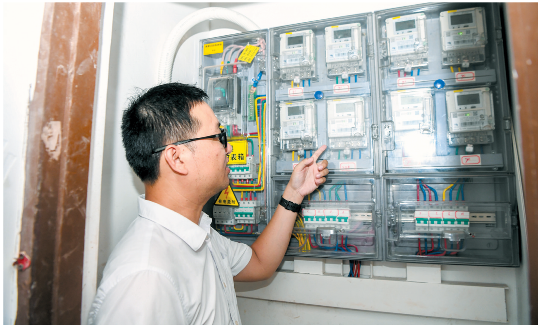
在富豪花园小区A座,工作人员介绍改造后的电路设备。
