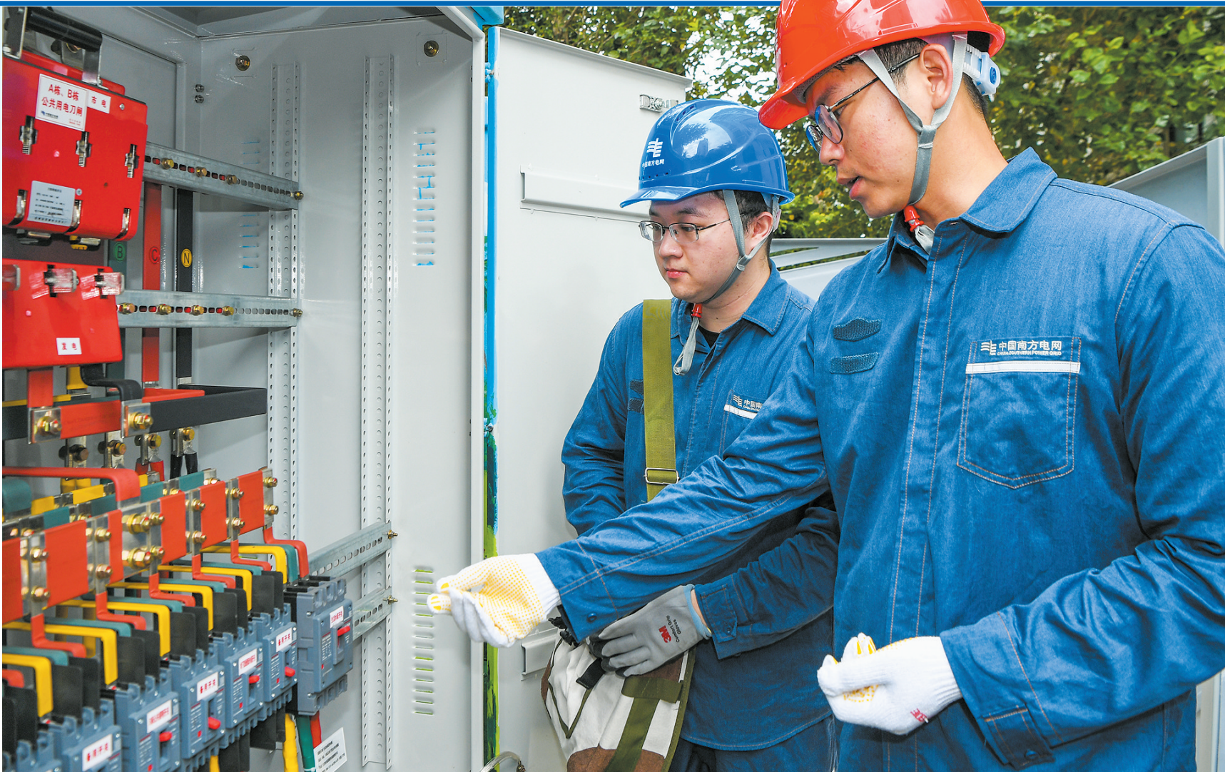
在阳光熙园小区,海南电网公司海口供电局工作人员正在检查低压电箱运转情况。
