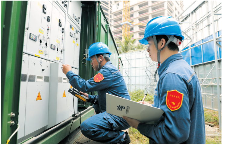
海南电网工作人员在开展供电设备巡检工作 本报记者 周慧 通讯员 杨永光 摄
