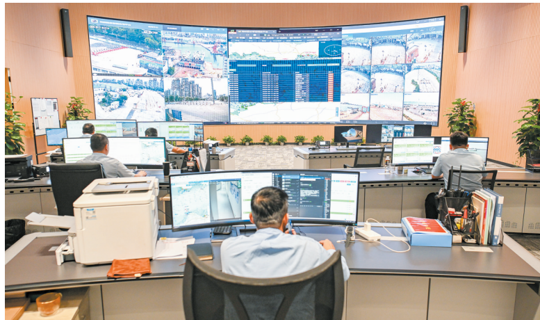
在海口新海港调度指挥中心,工作人员科学调度船只进出港。
