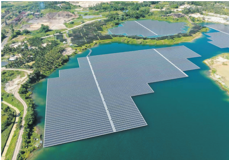
积水矿坑里漂浮式光伏板铺展在水面上。（受访者供图）
